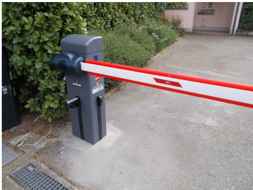
Barriera stradale BFT Condominio Le Stelle
